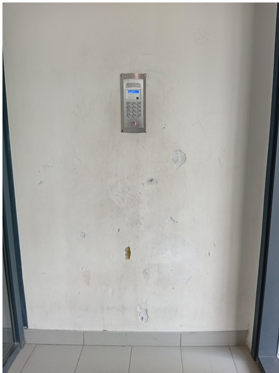
Фото 1. Исходное состояние мест общего пользования (ул. Большевисткая, 114)
