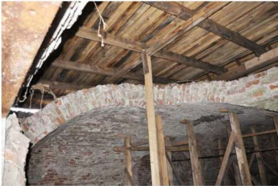
18. Участок обрушения сегмента свода.
