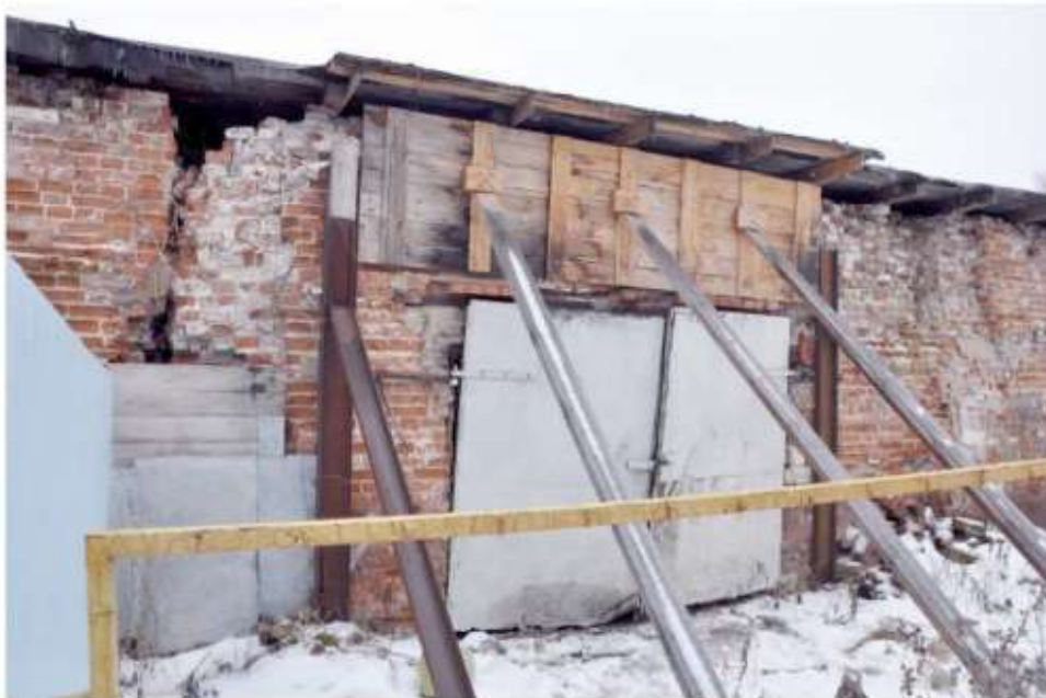
11. Западный фасад. Вывал центральной части стены.
