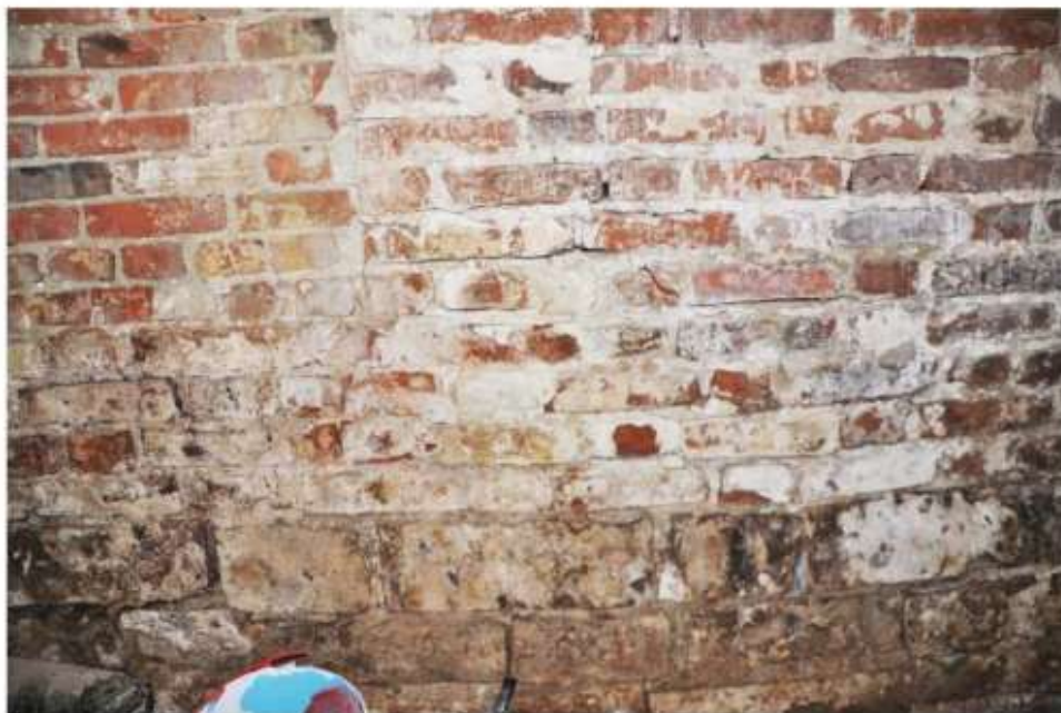
31. Просадка западной стены между южным окном и поздним входным проёмом.
