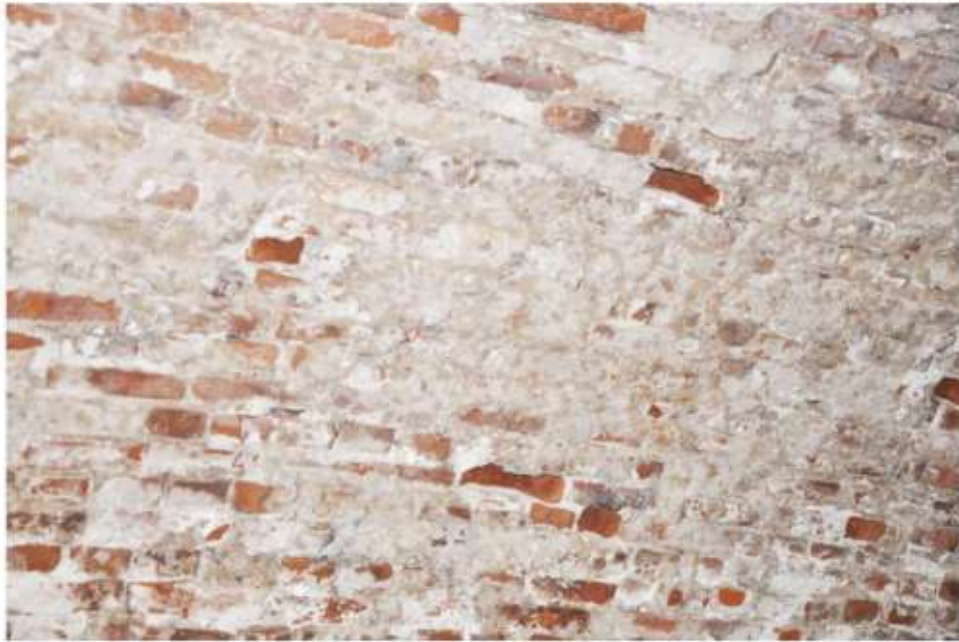
29. Трещина в своде, прилегающем к западной стене.
