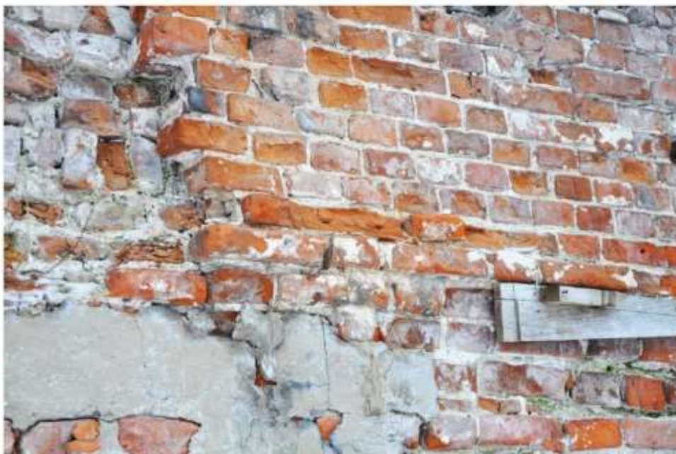
12. Расслоение лицевой кладки, западный фасад. Вычинка тычковой кладкой.
