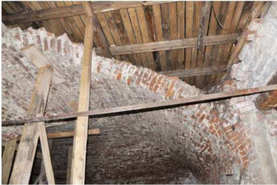
19. Участок обрушенного свода. Воздушная связь.
