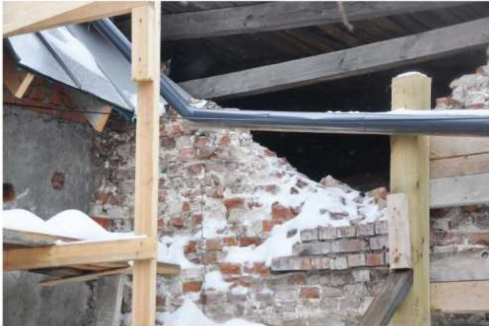
5. Вывал кладки в верхней части северной стены.
