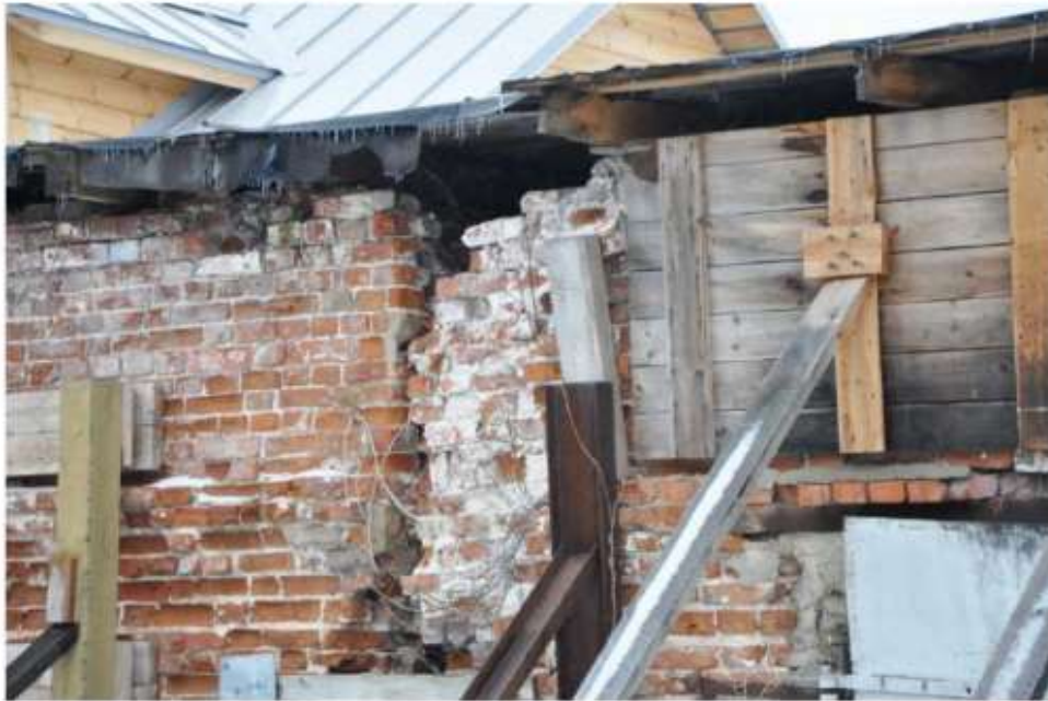
13. Сквозная трещина над растёсанном северном окне западного фасада.
