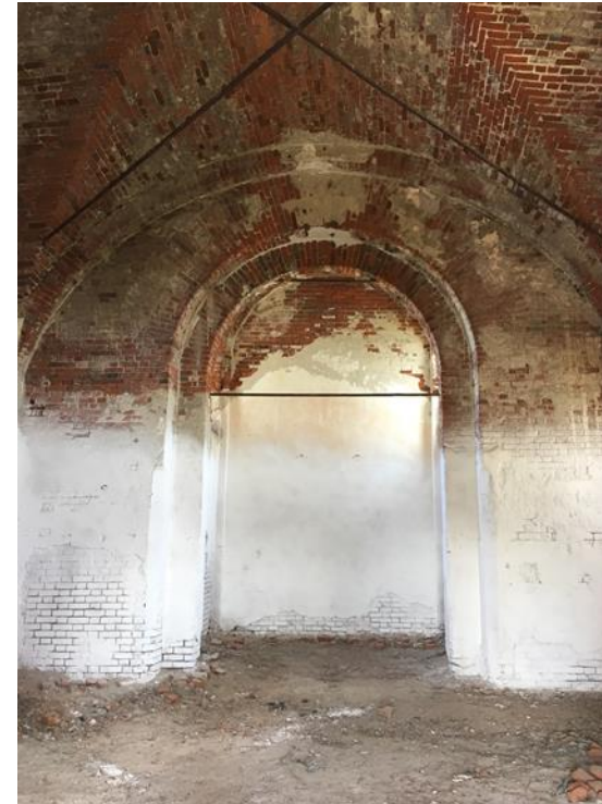
Фрагменты аварийного штукатурного слоя молельного зала Никольского храма
