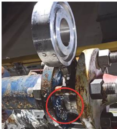
Рис. 5. Утечка на фланцевом соединении трубопровода водорода
