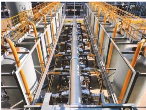
Рис. 9. Общий вид блока КЦА
