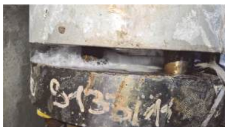
Рис. 6. Утечка на фланцевом соединении трубопровода продукта реактора
