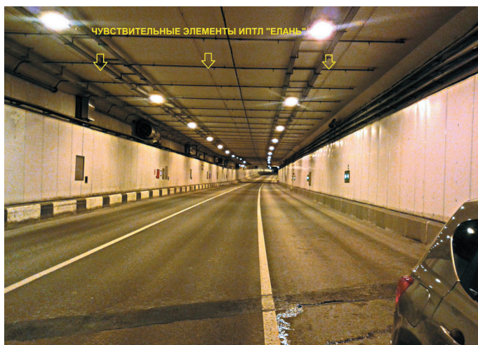
Москва. Алабяно-Балтийский автомобильный тоннель. Подвес оптоволоконного Чувствительного Элемента (ЧЭ) над дорогой.
