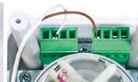
Фото 15. Подключение датчика к электроприводу
