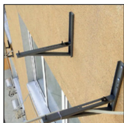
Крепление опор, держателей.
