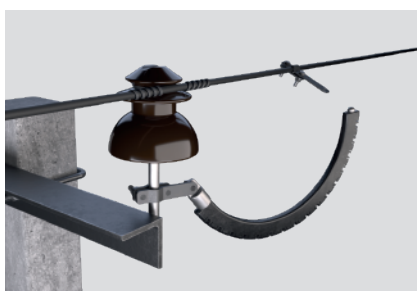
Установка РМКЭ-10 совместно со штыревой изоляцией
