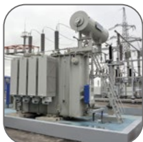
Объекты энергетической отрасли
