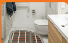
Электрического теплого пола
