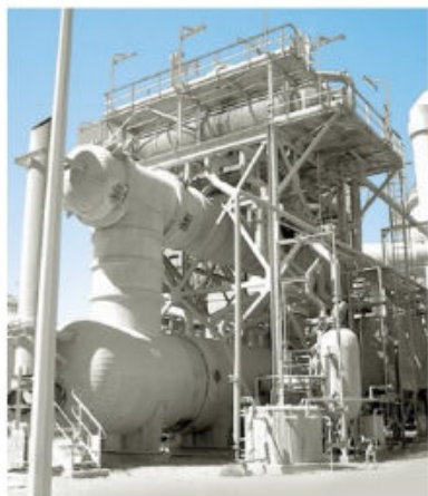
Рис. 106. Колонна синтеза аммиака
