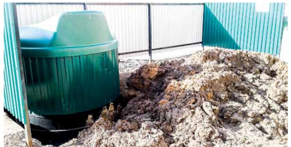
Идет трамбовка горной породой земельного участка вокруг контейнера заглубленного типа для последующего бетонирования (ул. Орская, 132/2)
