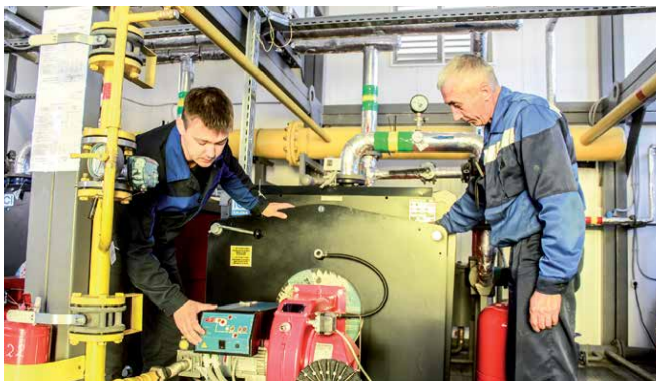
В котельной цеха по производству комбикормов. Инженер КИПиА А.А. Луценко и оператор котельной А.А. Харисов
