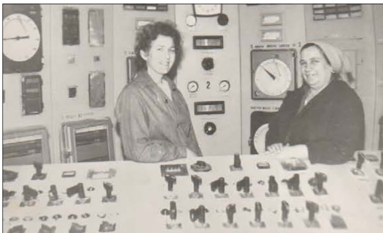
Пульт управления котлов, 1980 г. / Фото из архива АПТС
