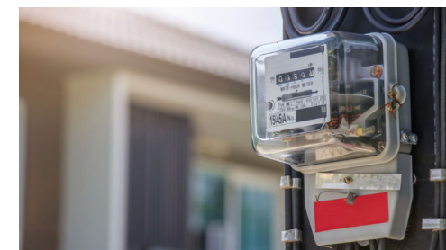
КИП и системы автоматизации
