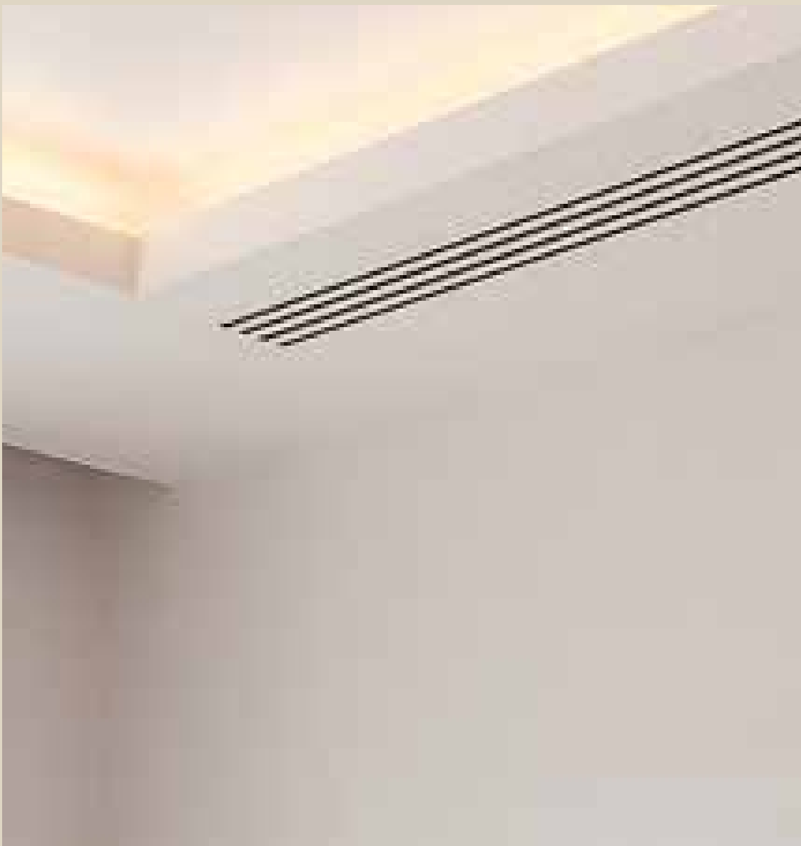
Система кондицио- нирования воздуха – потолочная, Daikin
