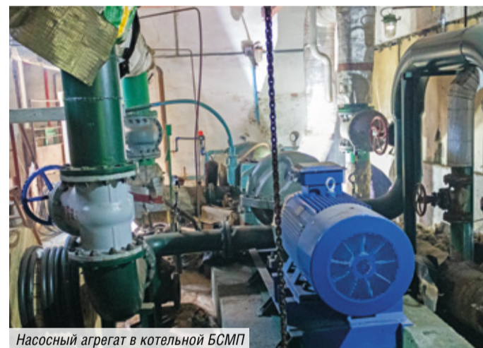
Насосный агрегат в котельной БСМП
