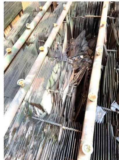
Рис. 1. Разрушение оросителя из-за падения наледи
