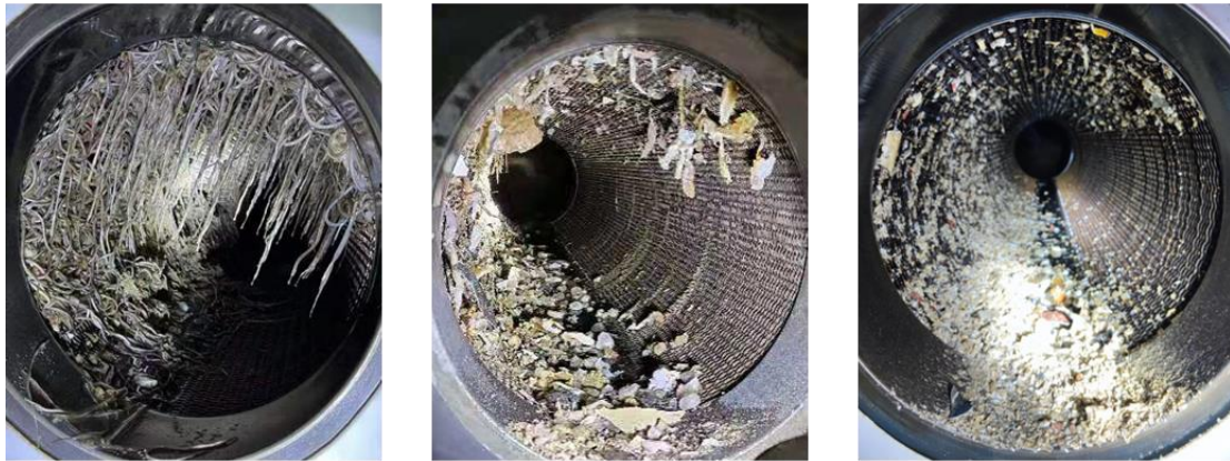
Загрязнения теплообменников системы промконтура охлаждения ответственных потребителей (КАА)
