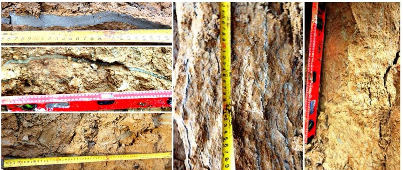
Рисунок 1.2. Трещины в грунте, заполненные инъекционным раствором при нагнетании по манжетной технологии (М.А. Самохвалов, 2016 г. [122]).
