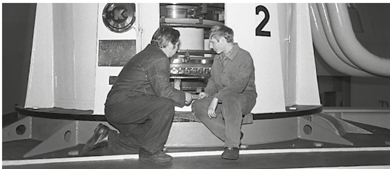
Осмотр щётчного аппарата генератора
