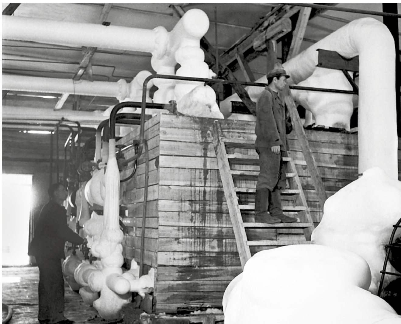
Холодильная установка в работе
