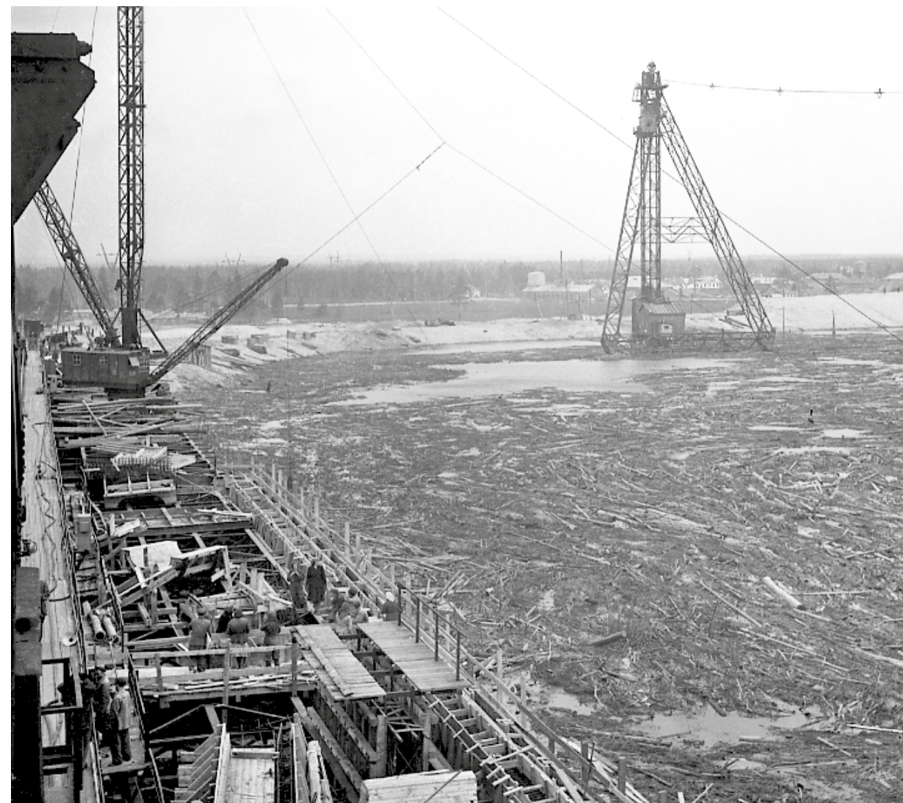
Плавающий мусор перед сооружениями
