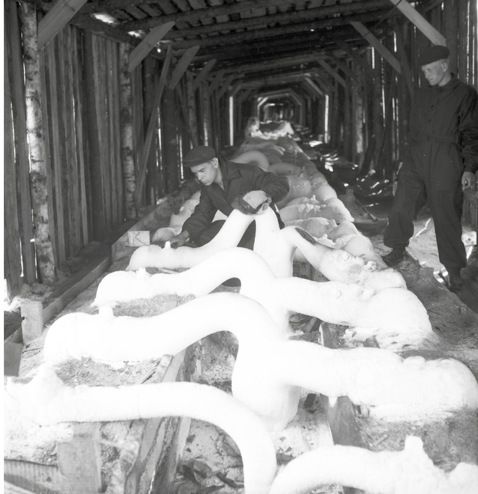
Галерея магистрального трубопровода холодильной установки
