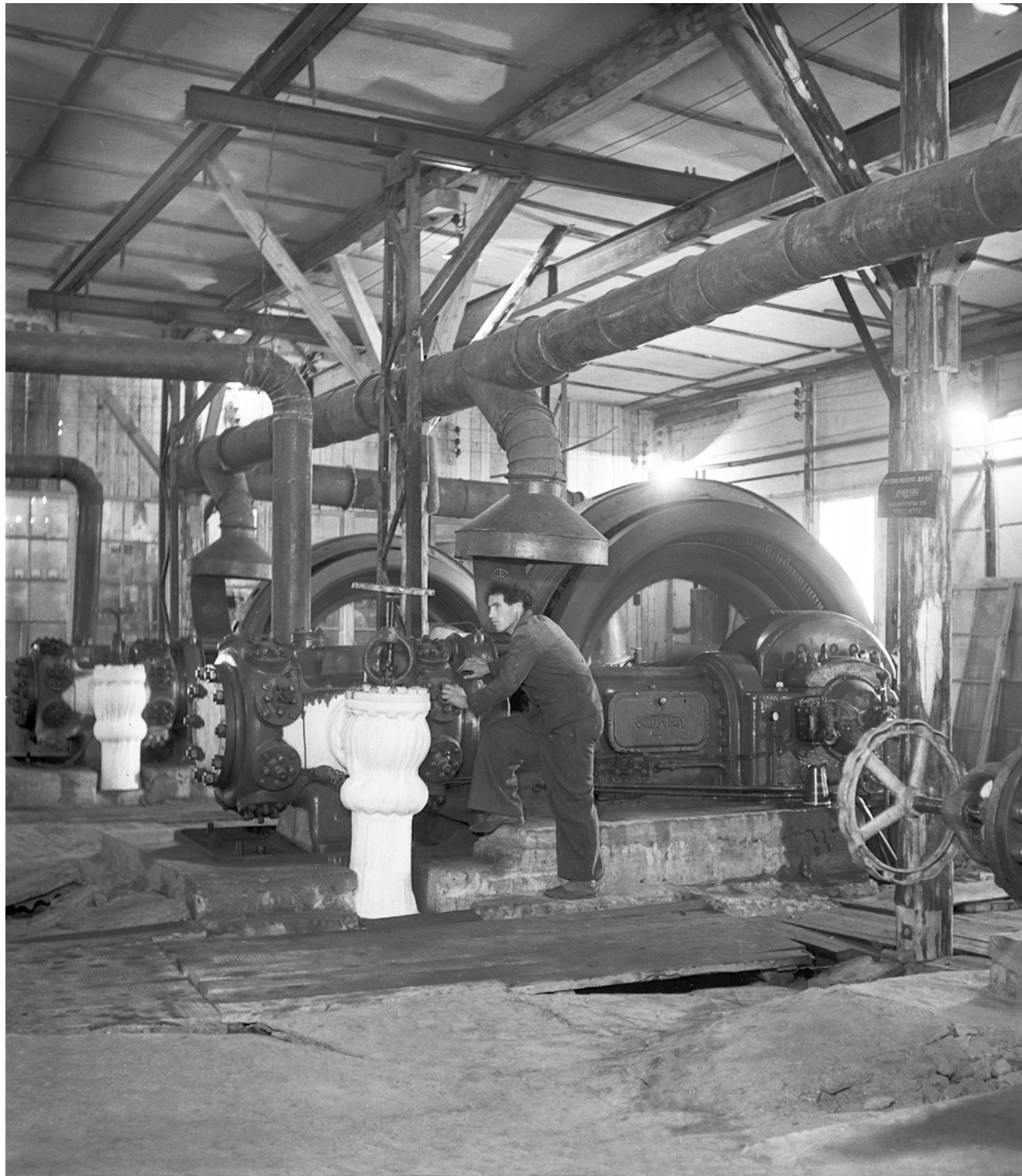
Компрессорная холодильной установки
