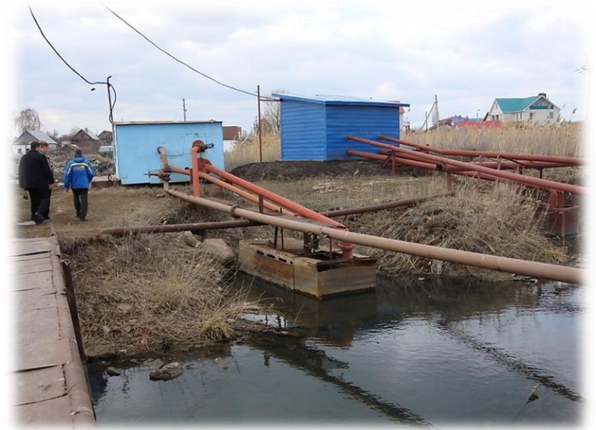
Работающая насосная станция ГЭС, открытая дренажная канава.
