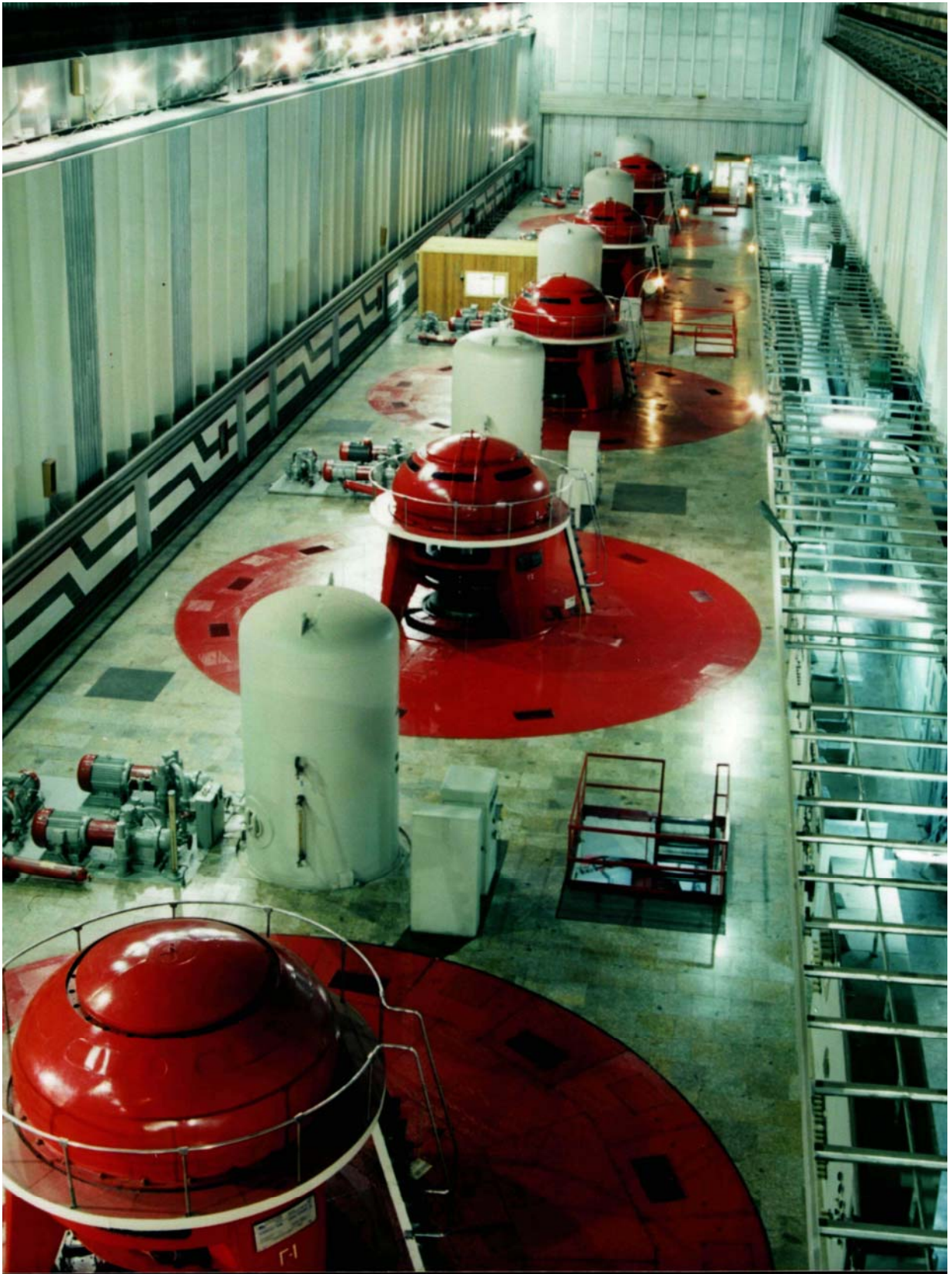
Колымская ГЭС. Машинный зал.
