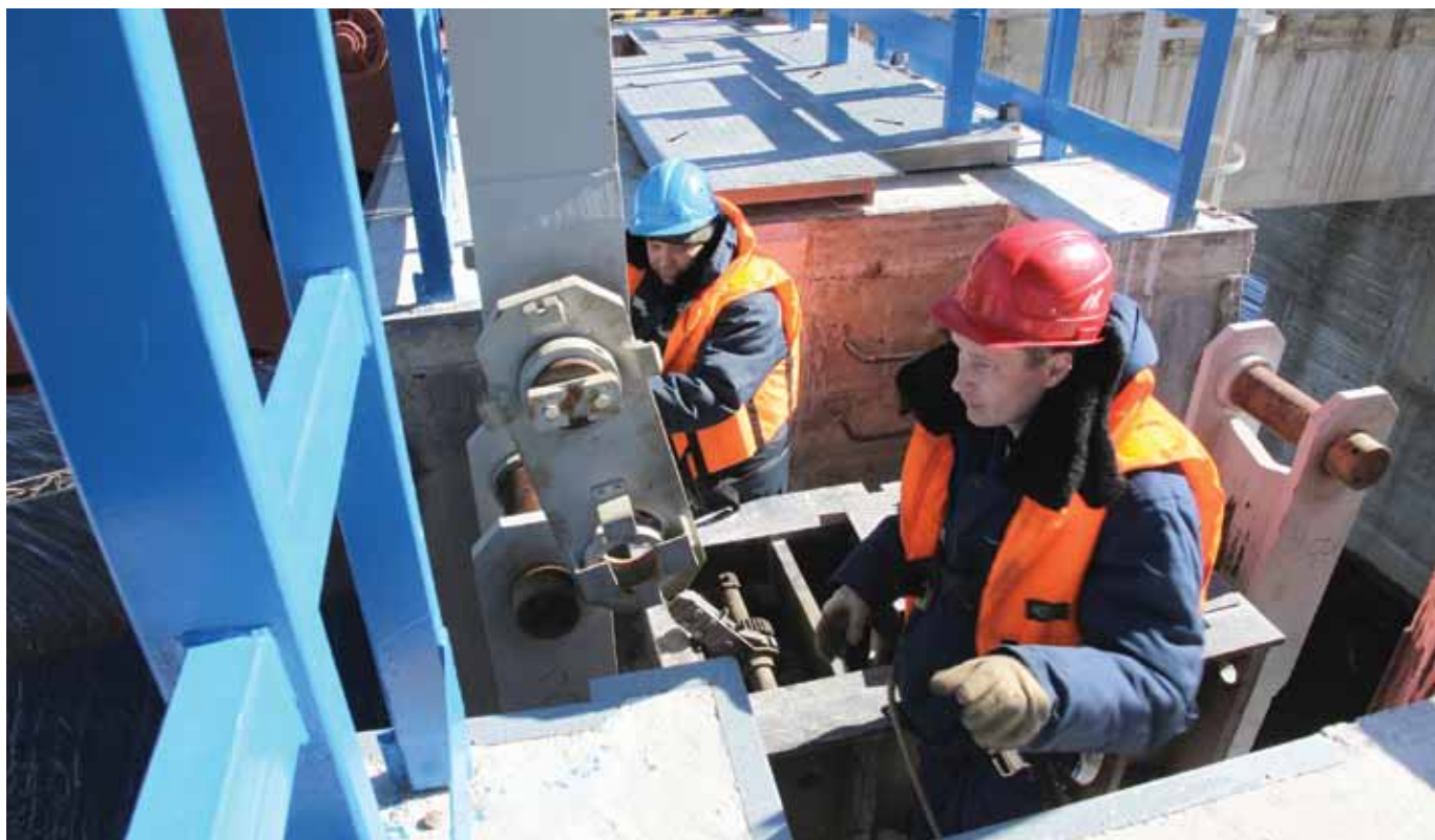
Рис. 3. Маневрирование затворами на Бурейской ГЭС. Фото пресс-службы филиала ОАО «РусГидро» — «Бурейская ГЭС».
