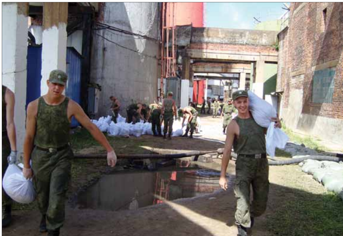
Рис. 1. Военные на сооружении дамбы для защиты Хабаровской ТЭЦ-2. Фото пресс-службы ОАО «РАО «ЭС Востока».
