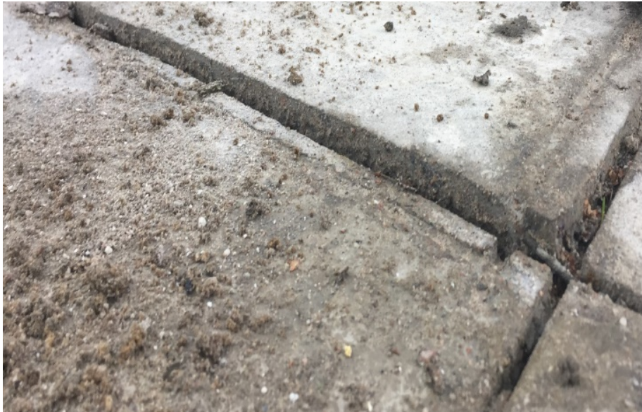
Рисунок 2.24 – Профиль бетонной плиты на инъектированном участке после нагнетания смолы
