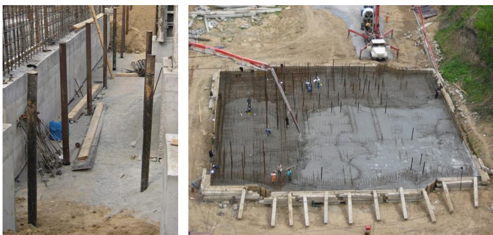
Рисунок 13. Инъекционные кондукторы, установленные в фундаментной плите для возможности усиления основания под подошвой (патент 2352723 РФ).
