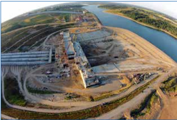
Загорская ГАЭС-2 Zagorskaya pumped storage PP-2
