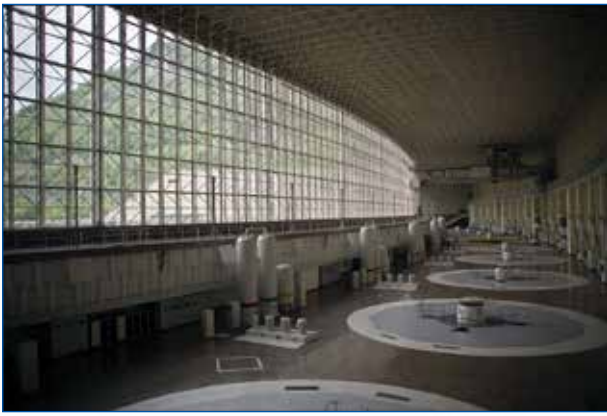
Саяно-Шушенская ГЭС Sayano-Shushenskaya HPP
