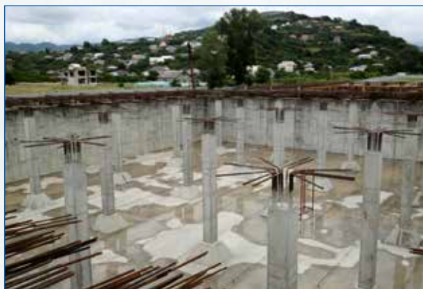
Сочи. Резервуар воды на 10т.м 3
