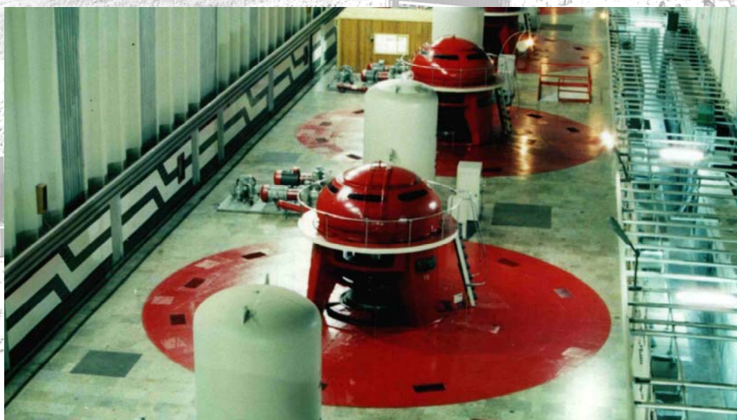
Колымская ГЭС. Машинный зал.
