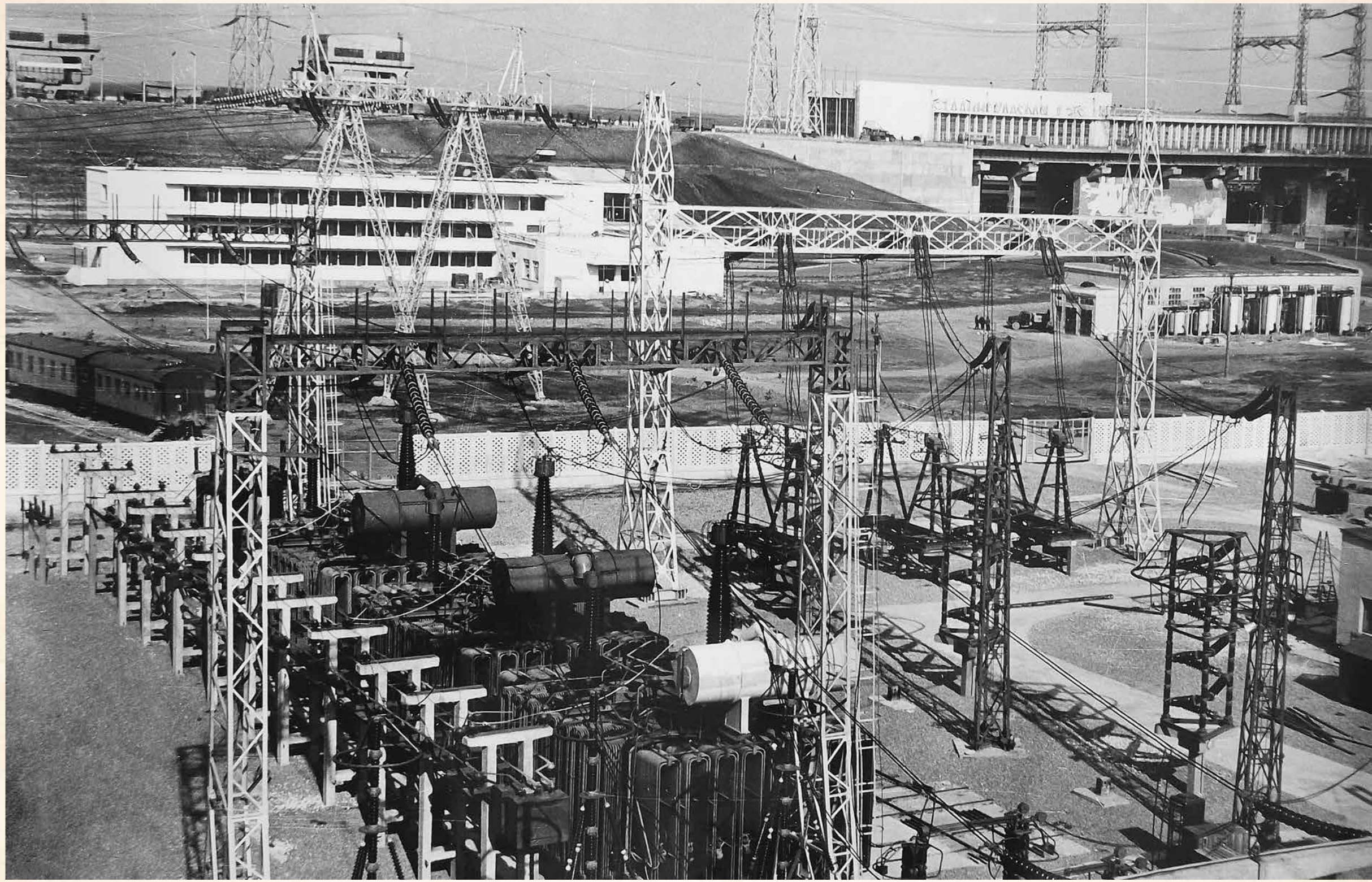
Открытое распределительное устройство 220 кВ. 1961 г.
