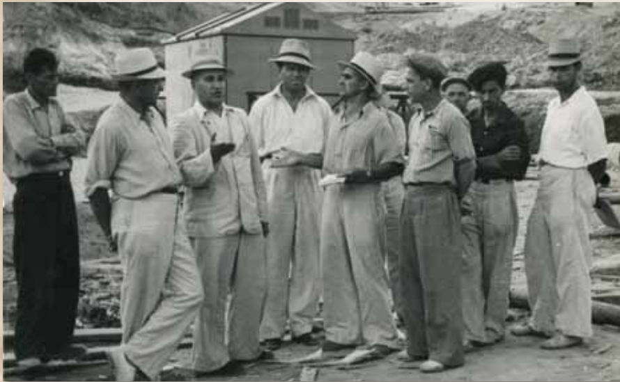
Г. А. Артыш (5-й слева) на строительстве Сталинградской ГЭС. Третий слева — Ю. И. Гаевский — начальник Сталинградгидростроя с ноября 1955 года по апрель 1956 года
