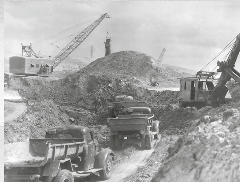
Земляные работы на участке 42-й плотины. Октябрь 1953 г. Фото Н. Новак и П. Керсиков.
