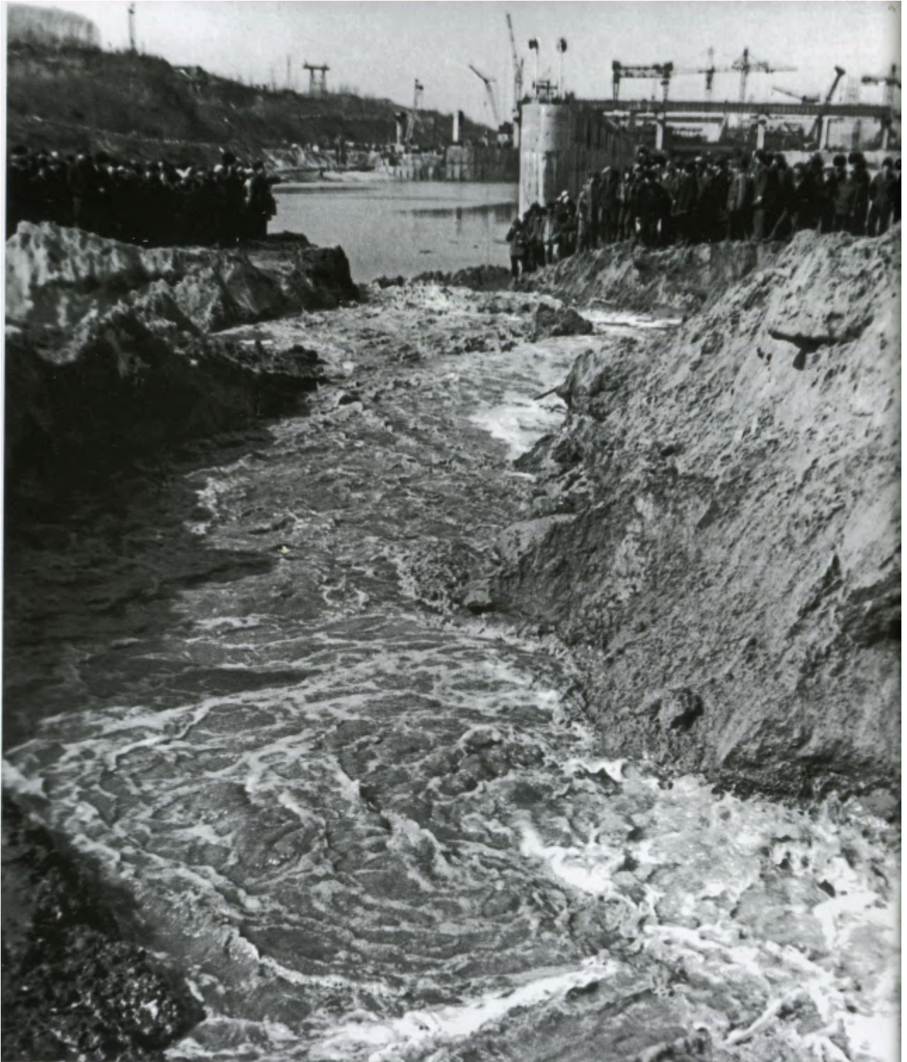
Затопление котлована. 4 ноября 1980 года.
