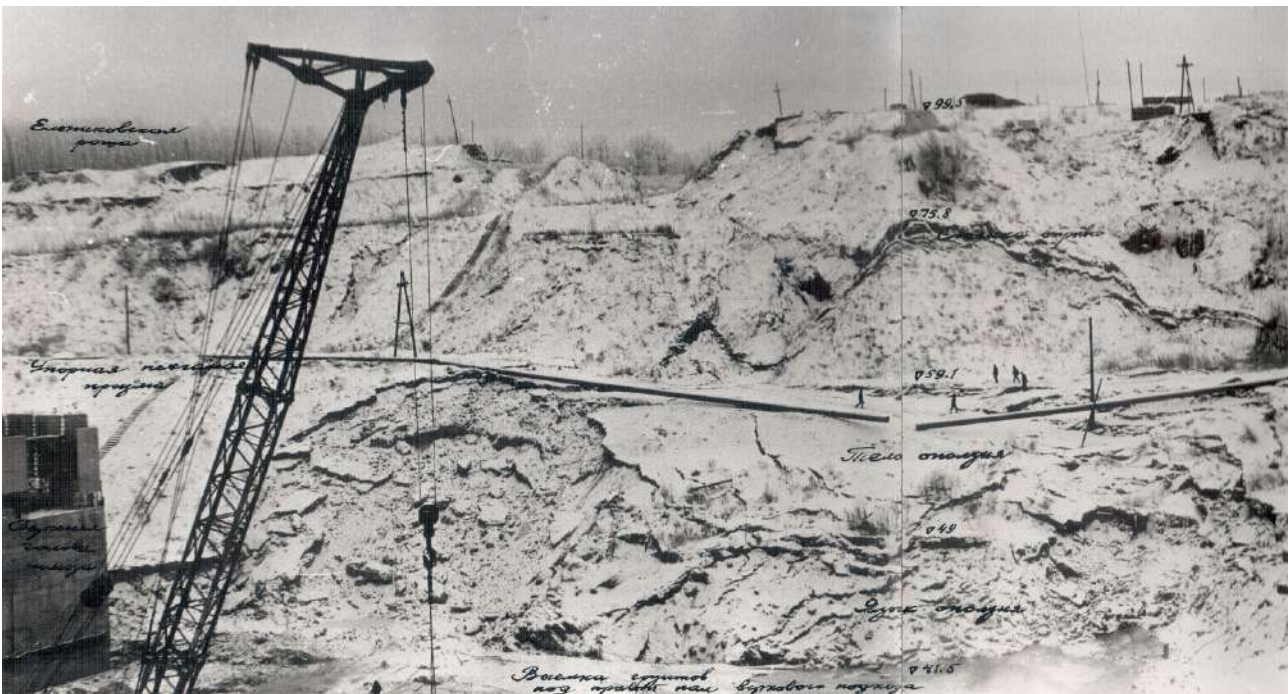
Котлован шлюза. Подвижка склона в виде оползня. 1973 год.
