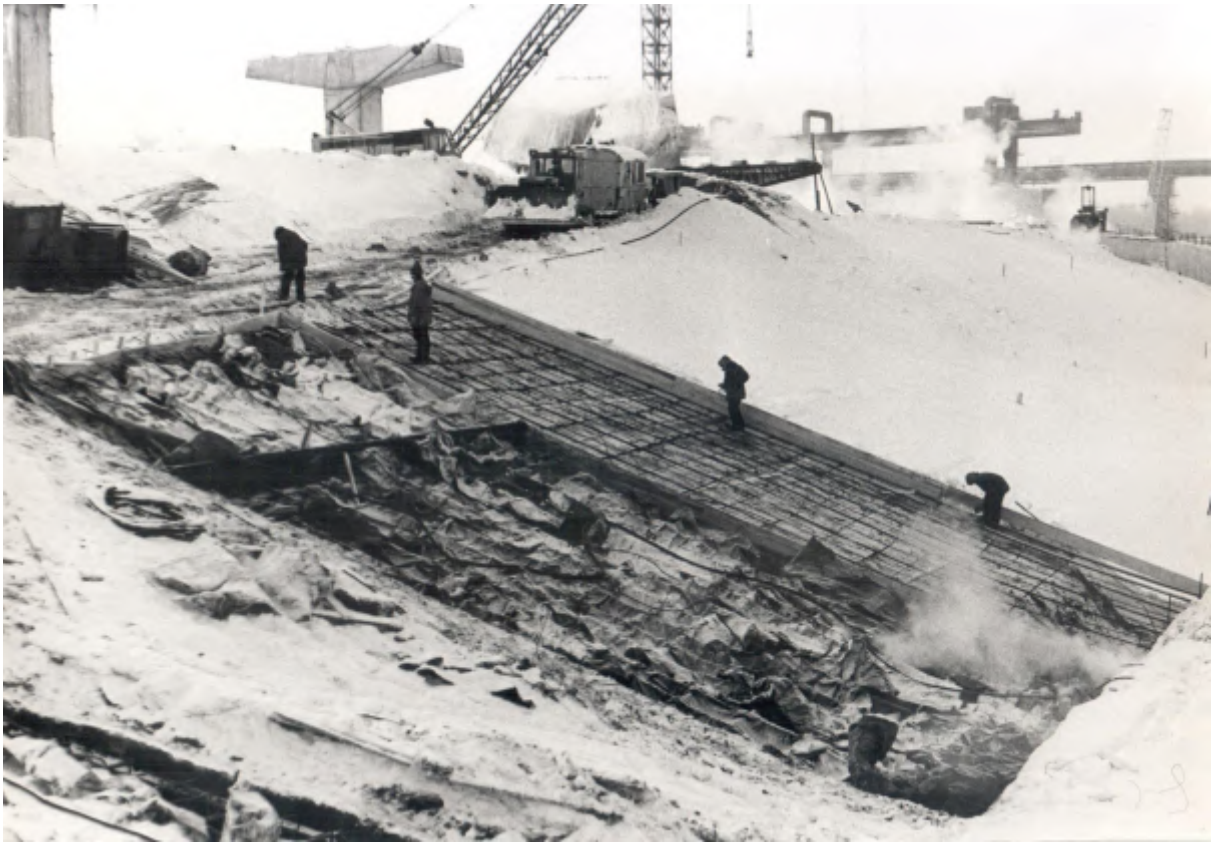
Участок сопряжения водосливной плотины и земляной плотины. Верхний бьеф. Бетонирование откосов. 1981 год.
