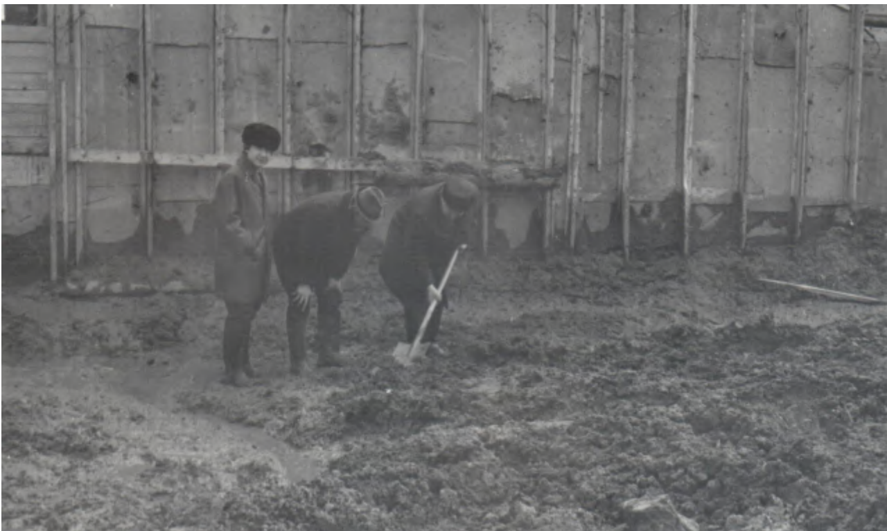
Окончательная зачистка основания низового подходного канала перед затоплением котлована. Слева – Сергей Егоров. 1980 год.
