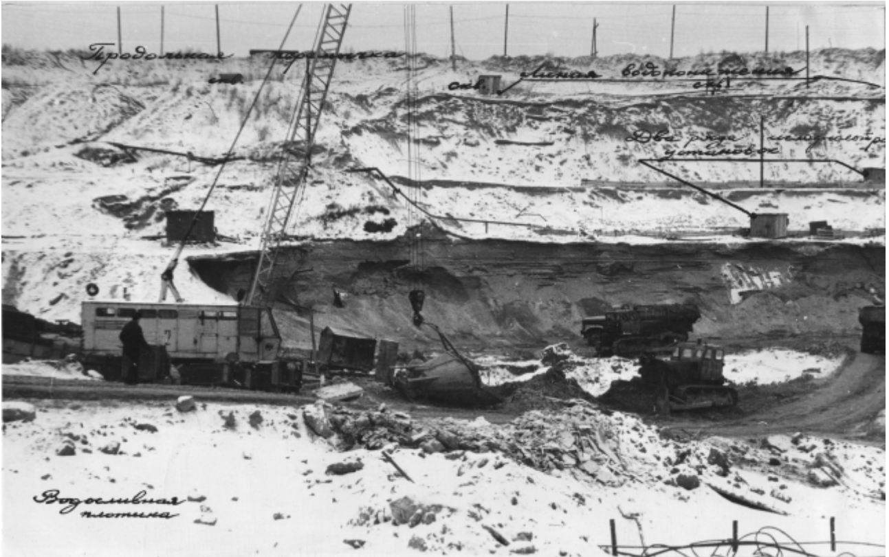
Стенка сопряжения водосливной плотины с земляной. Выемка грунтов под концевое крепление рисбермы. 1979 год.
