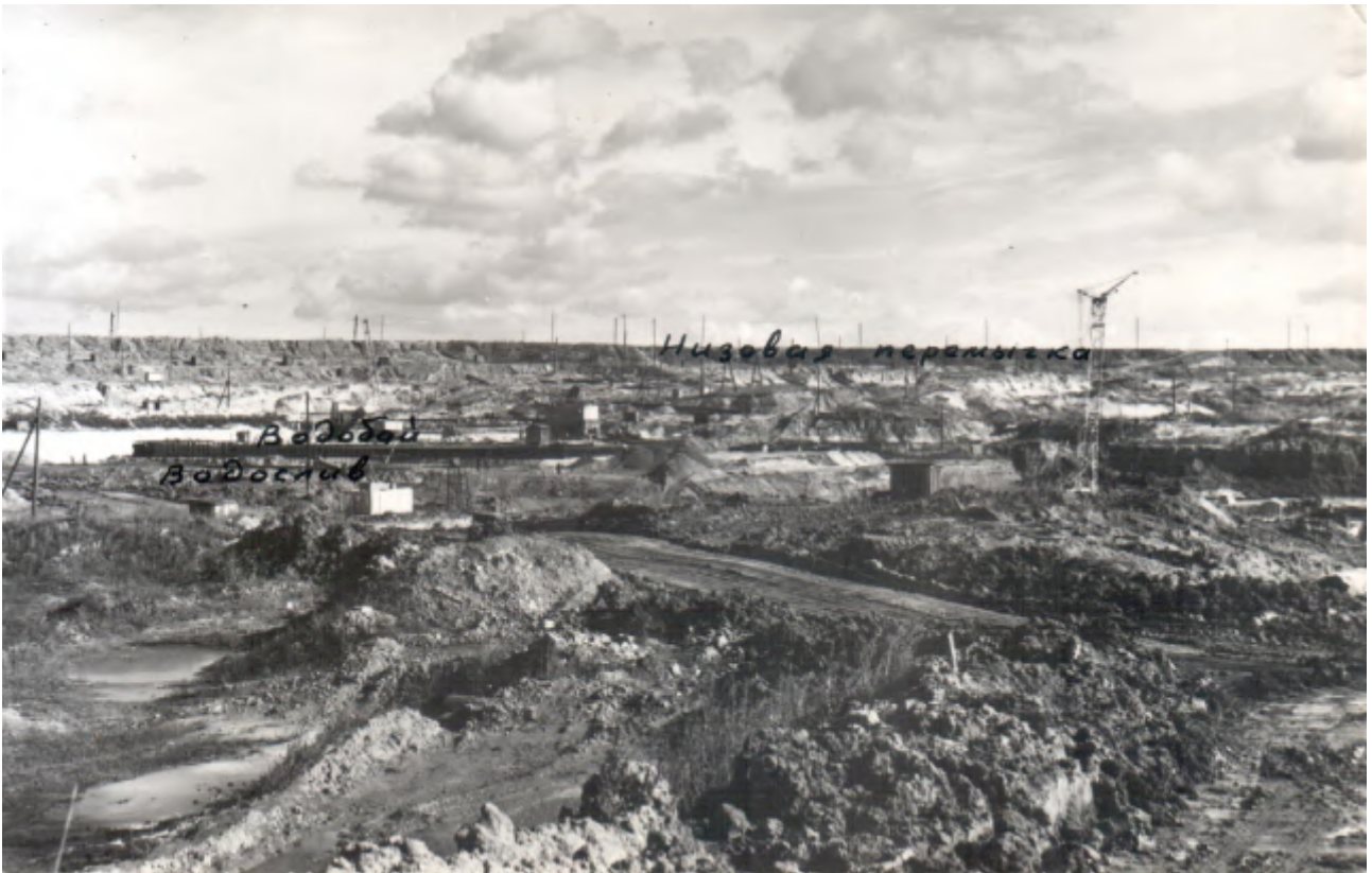
Котлован второй очереди в разгар строительства. Вид со стороны верхней перемычки. 1977 год.
