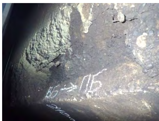
Рис. 1. Сборно-монолитная забральная балка (монолитная часть конструкции частично разрушена с обнажением сборной части)
