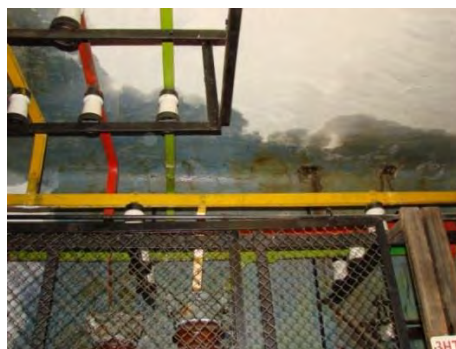
Рис. 9. Протечка масла из маслонапорной установки через перекрытие помещения закрытых распределительных устройств
