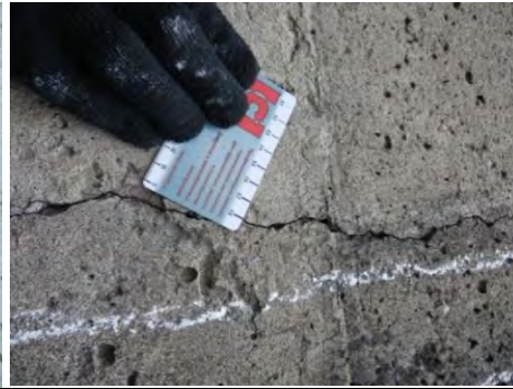
Рис. 6. Определение ширины раскрытия трещины, выходящей на поверхность конструкции, с помощью специального шаблона
