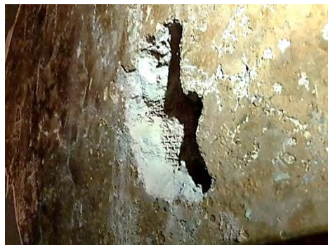
Рис. 8. Цементно-песчаная штукатурка на монолитном бетоне
