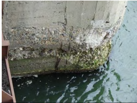
Рис. 5. Разрушение бетона бычков в зоне переменного уровня
