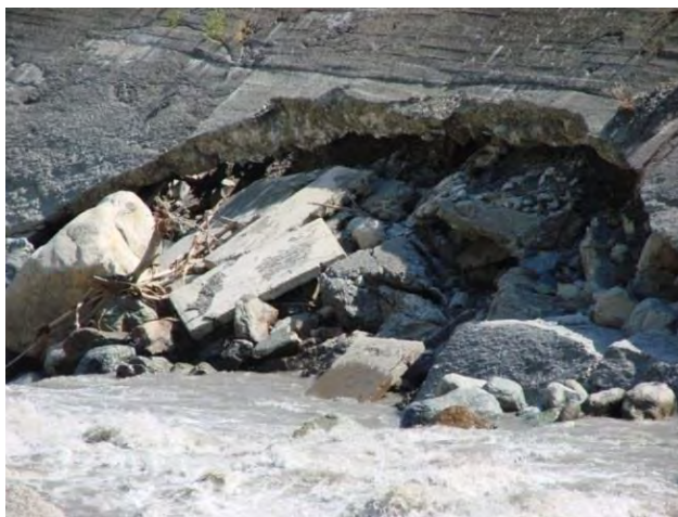
Рис. 14. Обрушение участка облицовки грунтового откоса канала над подплитной полостью
