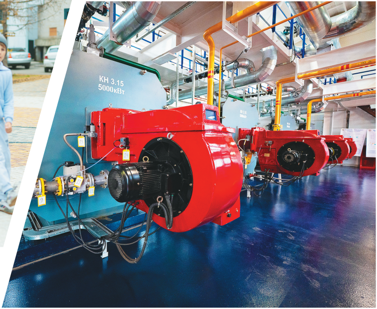
Ввод в эксплуатацию третьей умной котельной помог завершить программу перевода городской энергетики на экологичное топливо.
